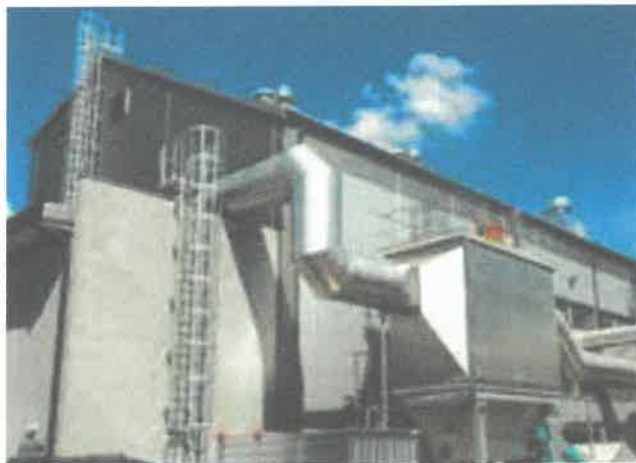
Zdjęcie nr 3 przedstawia budynek ciepłowni z systemem wentylacji.
