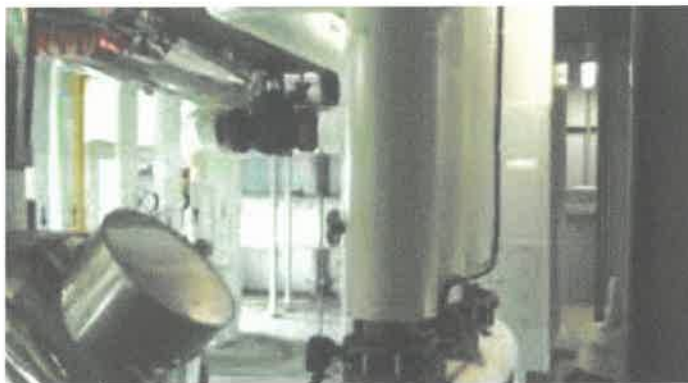
Zdjęcie nr 4 przedstawia wnętrze budynku agregatów kogeneracyjnych
