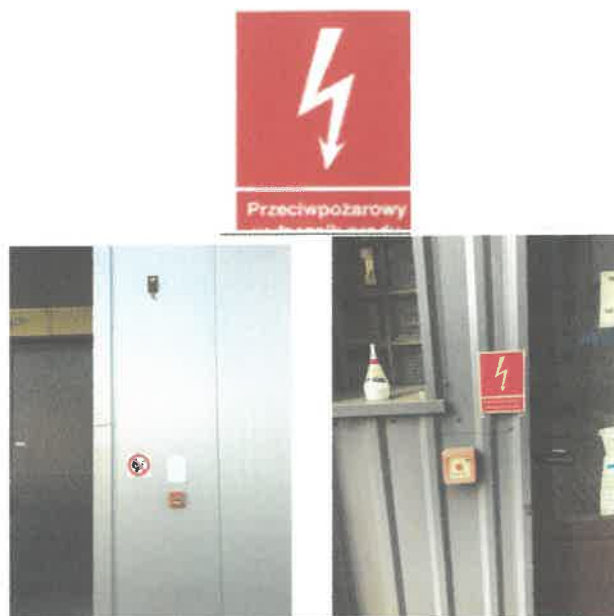
Fot Nr 11-12 przykładowe miejsca lokalizacji wyłączników prądu
